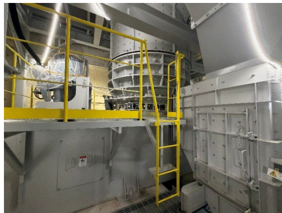
前処理棟高速回転破碎機
